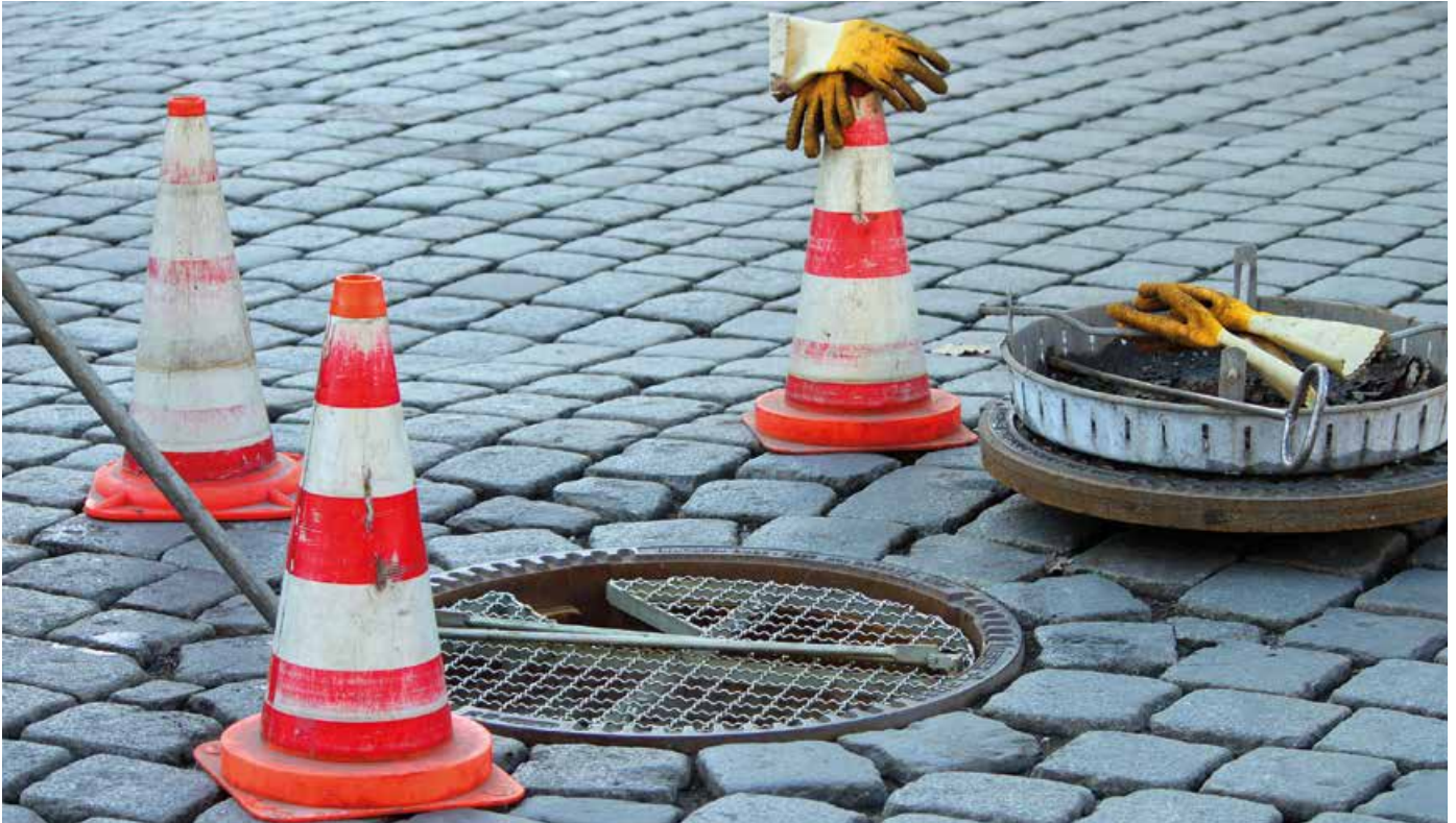
Abwassernetze müssen stets gepflegt und instand gehalten werden (Quelle: © blickwinkel2511 – Fotolia.com)
